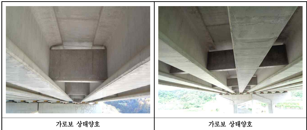
【사진 34.3.30】 가로보 손상현황
