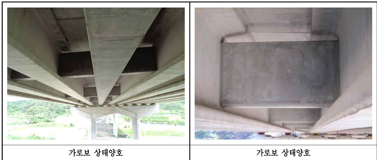
【사진 34.3.7】 가로보 손상현황
