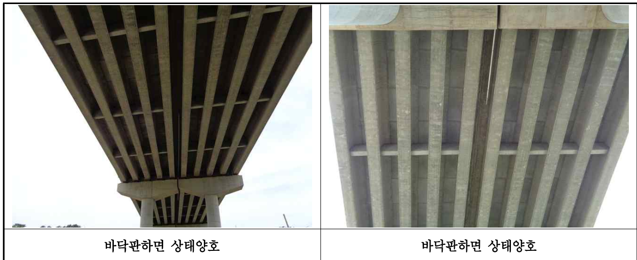
【사진 34.3.26】 바닥판하면 손상현황
