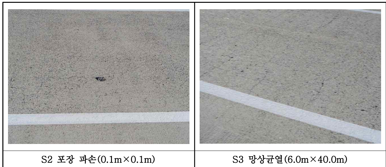
【사진 34.3.20】 교면포장 손상현황
