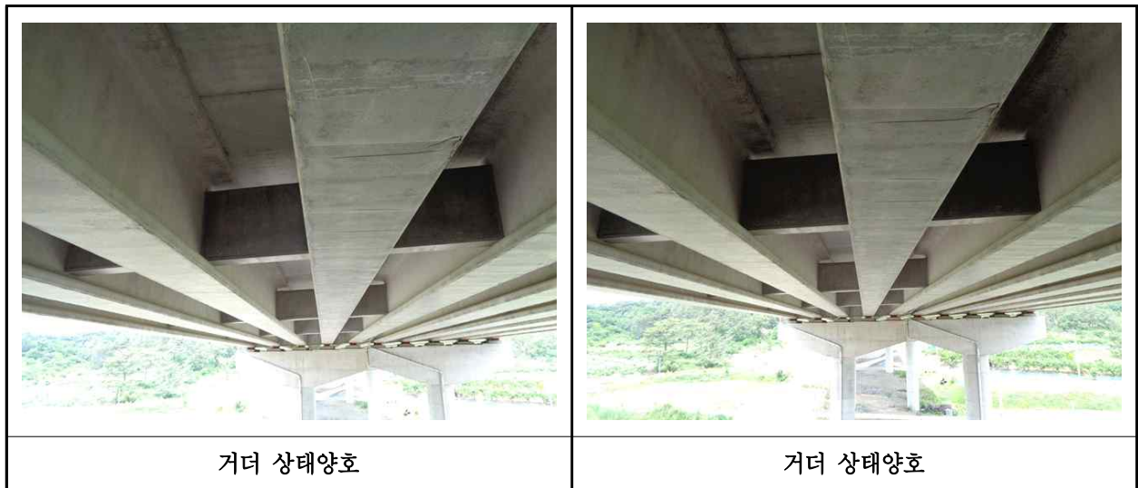
【사진 34.3.28】 거더 손상현황
